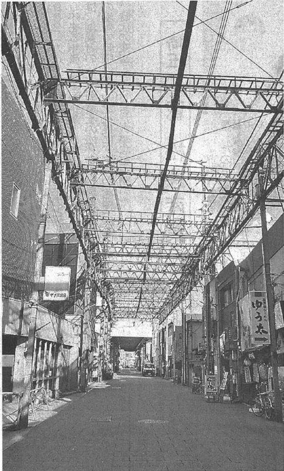
14年2月の大雪でアーケードが崩落した高崎市「中央銀座通り」の現場。屋台横丁として整備する計画だ
